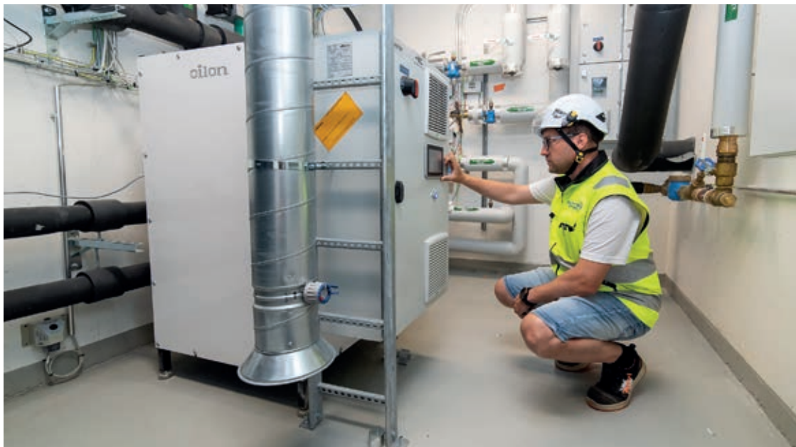
Rauman Energian kaukolämmön projektipäällikkö Juha Paturi tarkastuskäynnillä taloyhtiön teknisessä tilassa.
