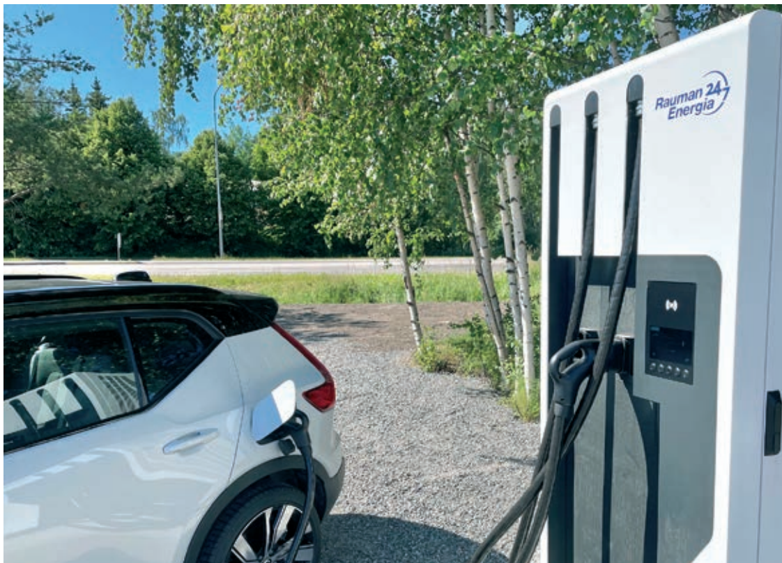
Pitkäjärven kioskin pysäköintialueen suurteholaturi otettiin käyttöön kesällä 2021.
